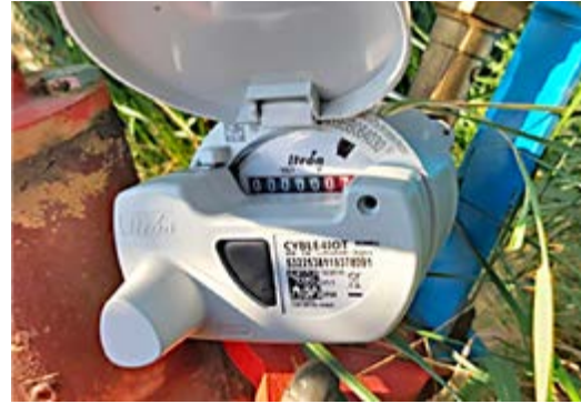
Les compteurs connectés sont déployés sur le réseau d'eau brute afin d'améliorer le suivi des consommations et d'intervenir plus rapidement en cas de fuite © BRLE
